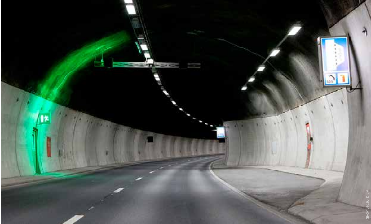
Туннель с освещенным аварийным выходом, нишей для аварийной остановки и аварийным телефоном / огнетушителем
