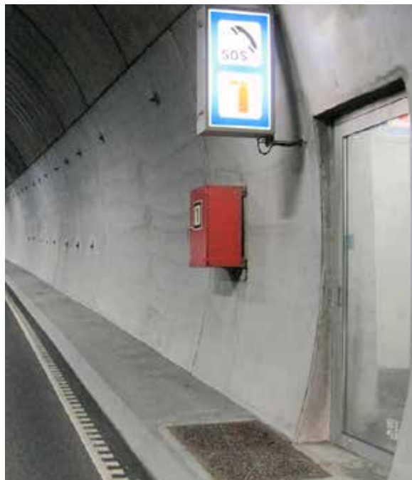
Аварийный телефон и огнетушитель в туннеле
